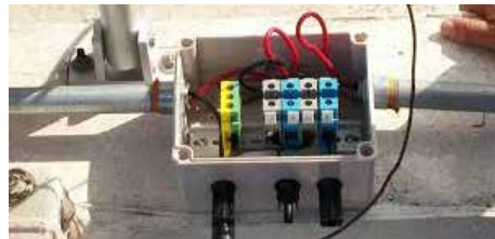
Cajas de conexiones eléctricas.
