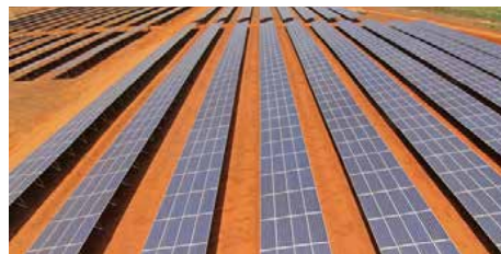
Campo de bancos fotovoltaicos
